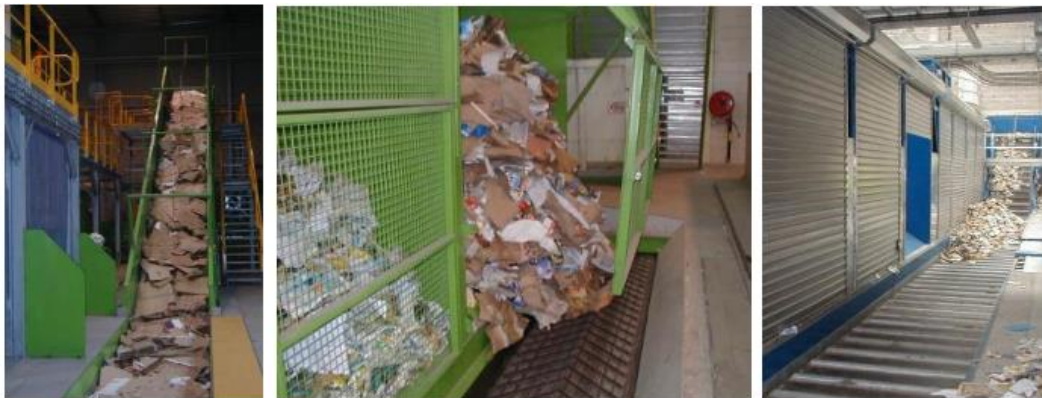
Figură 3-59 Exemplu de benzi transportoare de evacuare a silozurilor
