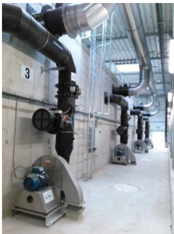
Figură 3-71 Sistem de aerare in zona tehnica
